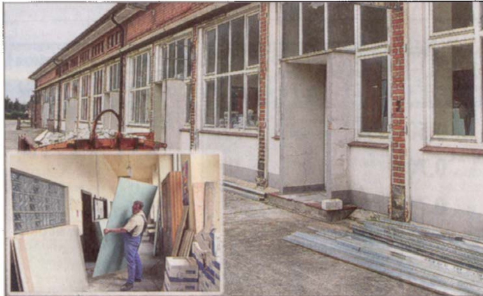
In diesem alten Kasernengebäude auf dem IUB-Campus entstehen momentan zwei Klassenräume, die sanitären Anlagen und ein Lehrerzimmer.
